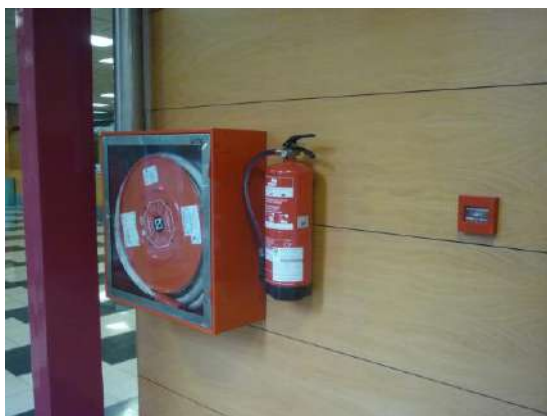
Foto 22. Equipaments protecció contra incendi
