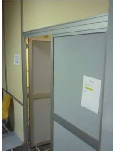
Foto 29. Absència il·luminació emergència
