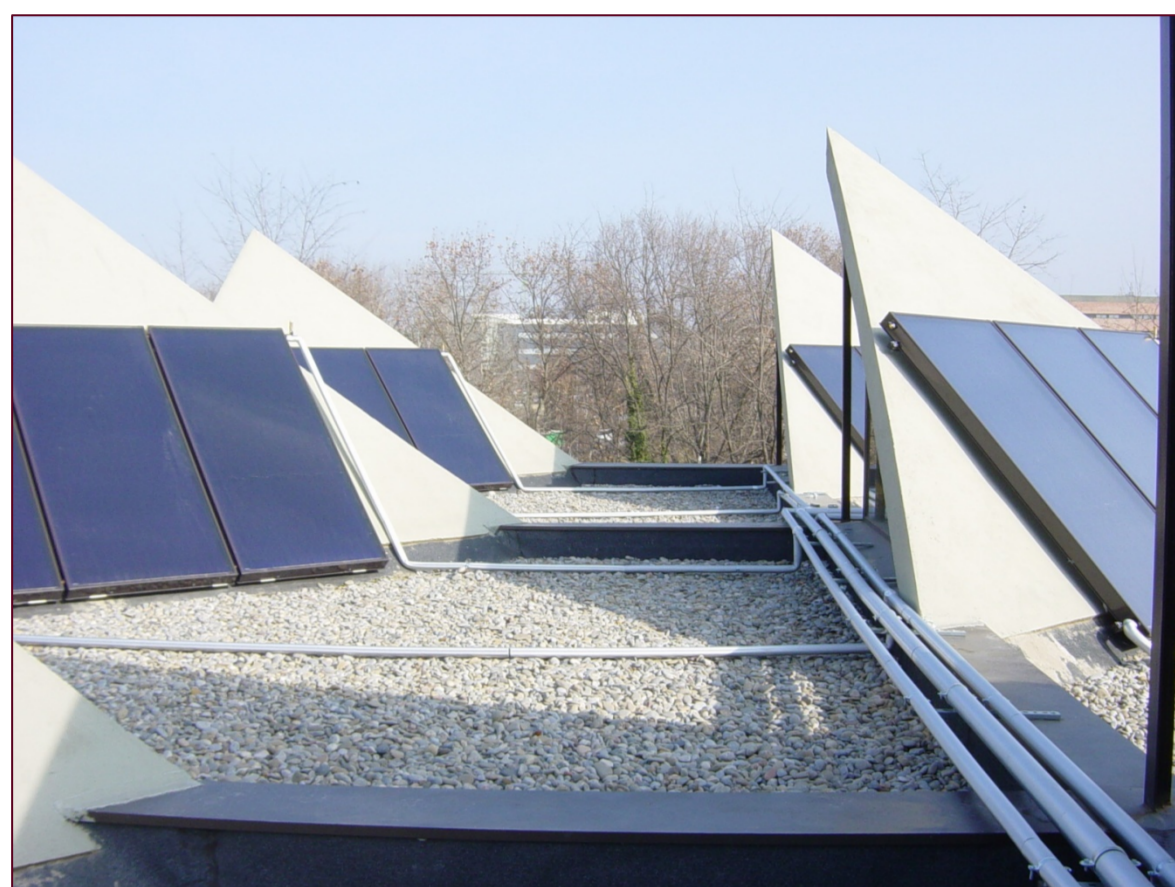
Instal·lació solar tèrmica al SAF
