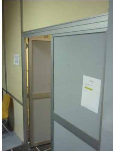
Foto 29. Absència il·luminació emergència
