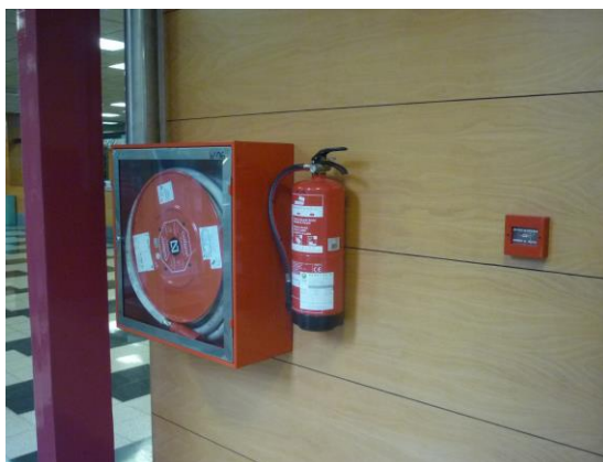
Foto 22. Equipaments protecció contra incendi
