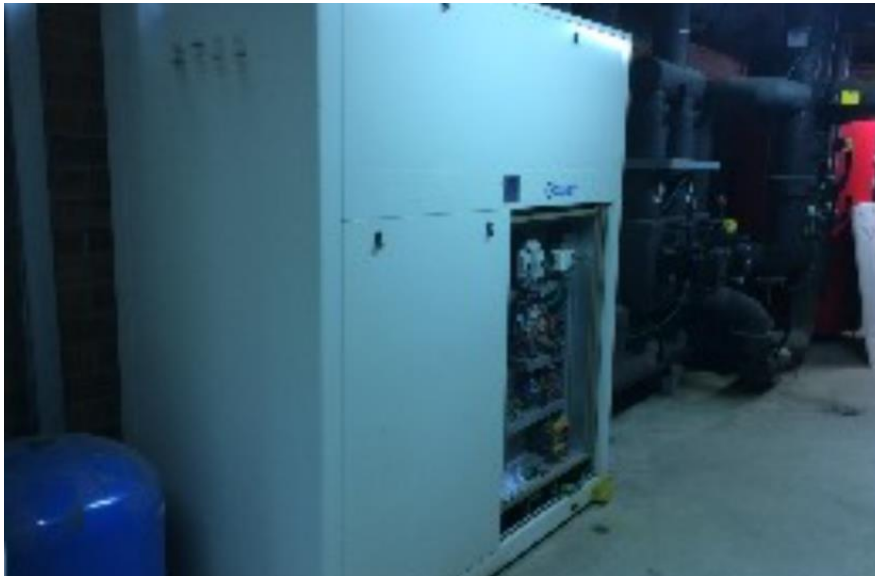
Fotografia 6. Bomba de calor geotèrmica ICTA-ICP, 2014.
