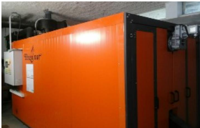
Fotografia 5. Caldera de Biomassa SAF, 2006.
