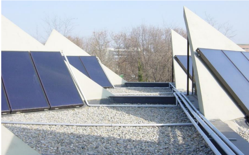
Fotografia 4. Planta solar tèrmica SAF, 2005.
